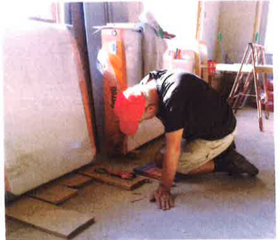
Installatie van de CV
